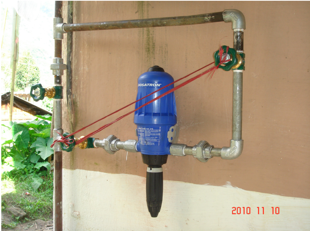
Bild 6: Installierter Wasserfilter „Dosatron“ zur Dosierung von „AnoQuel“.
