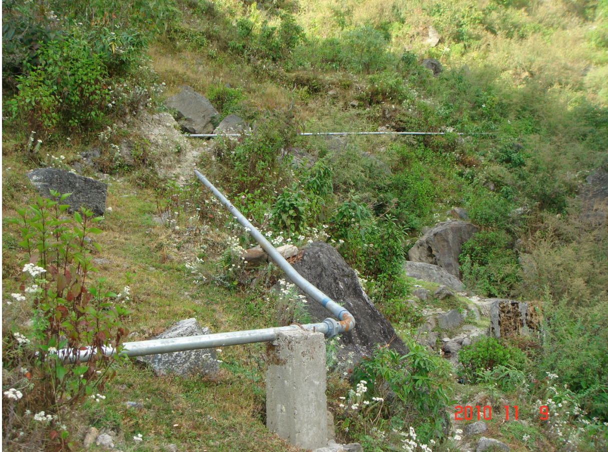
Bild 3 : Wasserleitung aus Stahlrohr.
