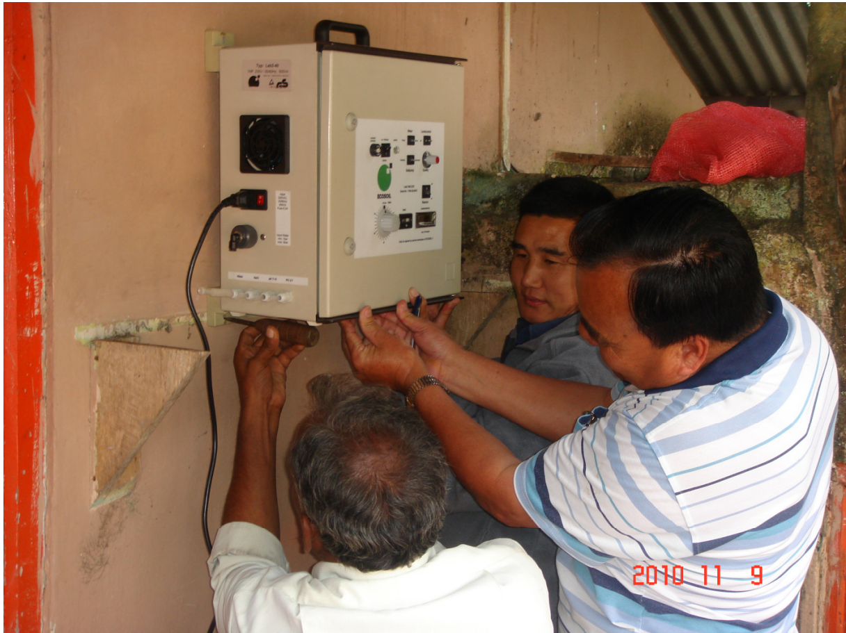
Bild 5 : Montage des „BioQuel-Gerätes“ auf der Terrasse des „Girls-Hostel“.
